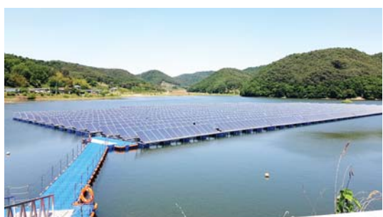
나주 대도저수지에 설치된 수상태양광 발전단지.
