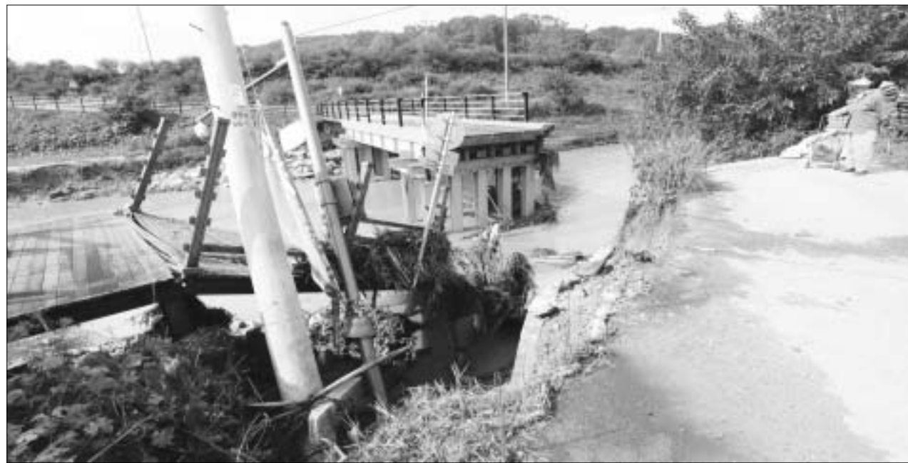
집중호우로 끊긴 다리 4일 오전 세종시 부강5리 세월교가 지난 밤에 내린 집중호우로 유실돼 끊기자 이 다리를 통해 밤에 가려던 한 주민이 되돌아가고 있다. 이 다리는 지난해에도 유실돼 보수공사를 했다.
