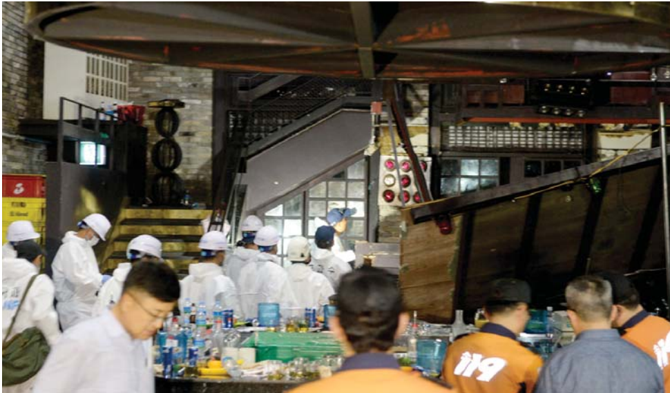
지난 7월 27일 오전 2시39분께 광주 서구 치평동 클럽 내부 복층 구조물이 무너져 2명이 숨지고 16명이 부상을 입었다. 이날 오후 경찰이 사고 원인을 규명하기 위해 국립과학수사연구원 등과 합동 감식을 벌이고 있다.
