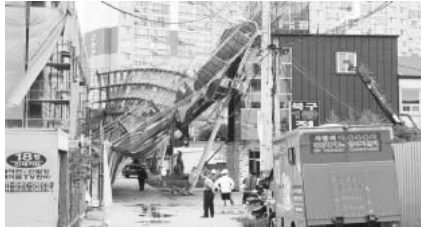
제 13호 태풍 '링링'이 서해안을 지나 북상 중인 7일 오전 광주 북구 오치동 한 건설 현장에서 안전펜스가 강풍에 쓰러져 공사 관계자들이 복구작업을 벌이고 있다.
