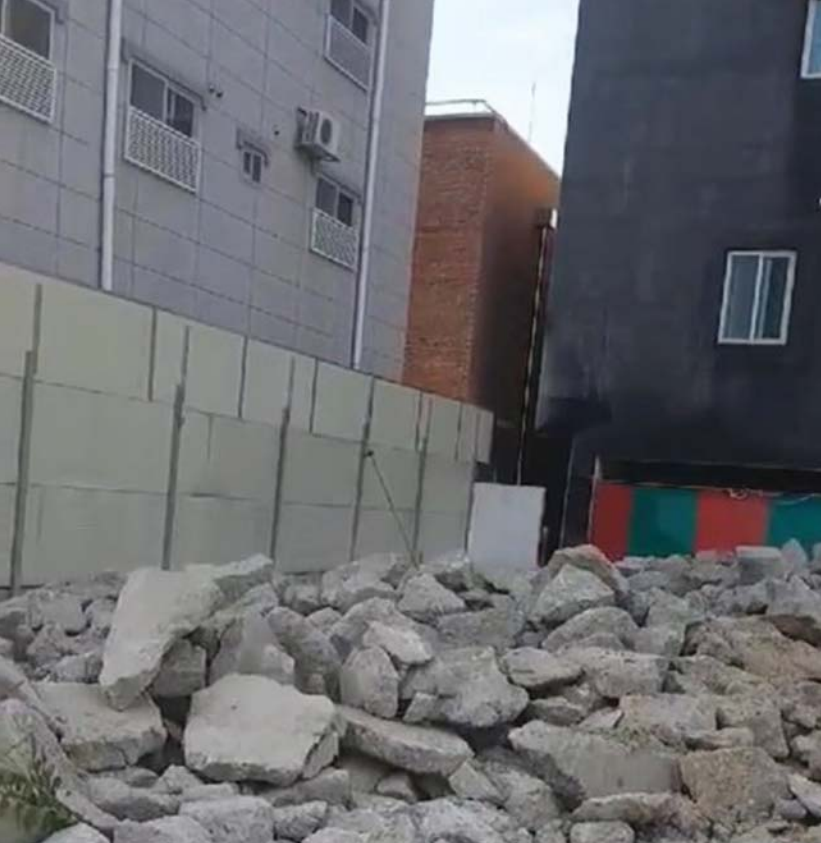
광주 광산구 모텔 증축공사중 주차장 시멘트 바닥해체 작업으로 인해 인접 다세대 주택이 기울고 균열피해를 입고 있다.
