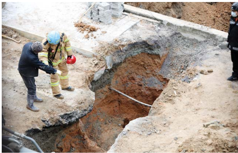
지난 1월31일 오전 광주 서구 마북동 한 아파트 인근에서 하수관로 공사 중 토사가 무너지는 사고가 발생해 소방당국이 사고 현장을 수습하고 있다.
