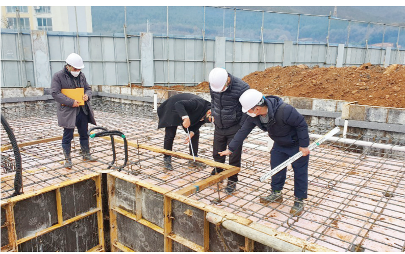
내·외부 전문가로 구성된 현장점검반이 강진 농촌형 공공임대주택 조성사업 현장을 방문해 점검하고 있다.
