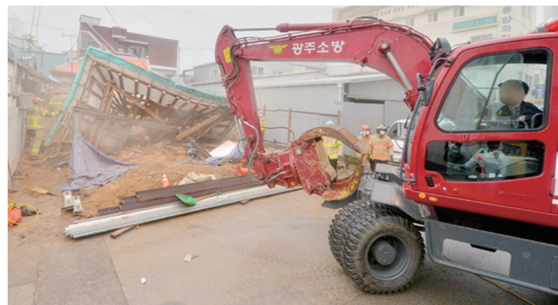
4일 오후 4시20분경 광주 동구 계림동 한 주택 개축 현장에서 무너진 건물 더미에 작업자 4명이 매몰, 굴삭기를 동원한 구조 작업이 펼쳐지고 있다.
