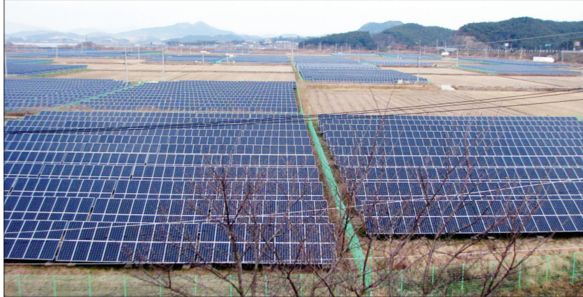
영암군 삼호읍 일대 농지에 설치된 태양광발전시설.
