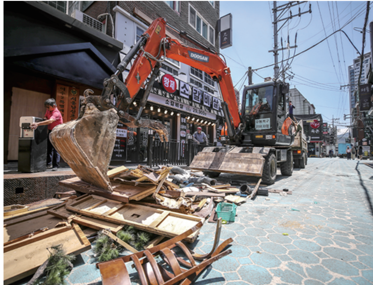
굴삭기 동원해 수해 복구 작업 16일 오후 서울 동작구 흥신대입구역 인근 수해 피해 현장에서 굴삭기 수해 복구 지원 관계자들이 굴삭기를 동원해 복구 작업을 하고 있다. 뉴스스
