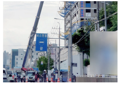
'거푸집 추락 위험' 광주 신축 공사장 내 크레인 작업중지 명령
