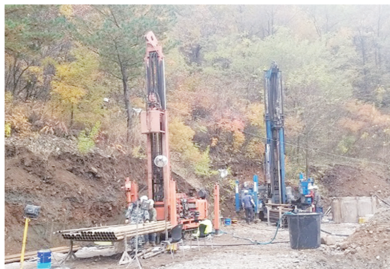
구조당국이 고립된 작업자들의 생존 신호를 확인하기 위해 고립된 작업자 대피 예상지역에 천공기 2대를 이용해 170m 깊이 구멍을 뚫는 시추작업에 들어갔다.
