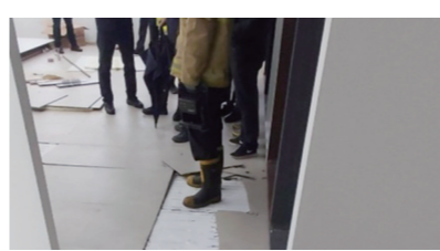
광주 또 건물 바닥 균열 대피, 인명 피해 없어
