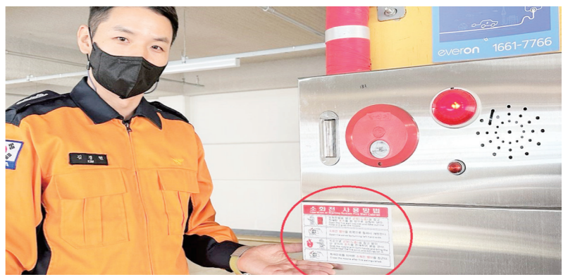
순천소방, 옥내소화전 사용설명서 한글 외국어 동시표기 홍보 순천소방서는 소화기와 더불어 화재 발생 초기에 신속하게 진압할 수 있는 옥내소화전에 외국어와 그림이 포함된 사용설명서 부착에 나섰다. 순천=김승호기자
