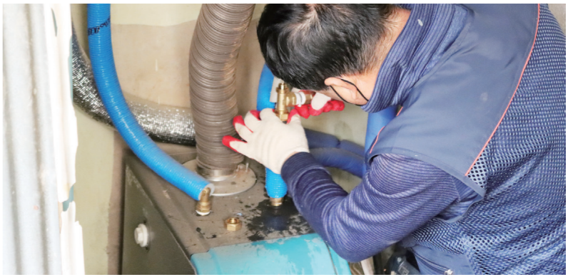
광양소방서, 화목보일러를 안전하게! '간이스프링클러 설치'
