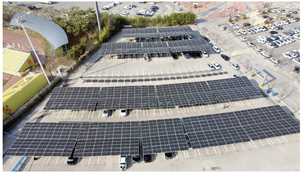
광주 월드컵경기장 주차장 부지에 조성된 태양광 발전소. (사진=광주도시공사 제공)
